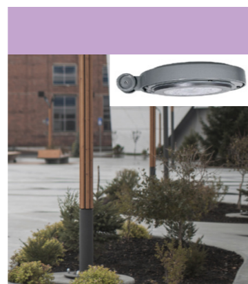
Прожекторы на опорах Опора бамбук высота 4 м светильник 2 (тасна 45) 15 шт
